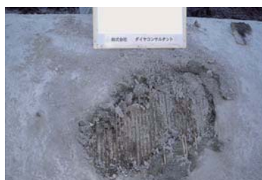
劣化状況の例
