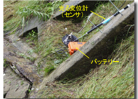
光る変位計の設置状況
