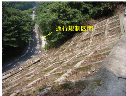
道路斜面崩落による通行規制状況
