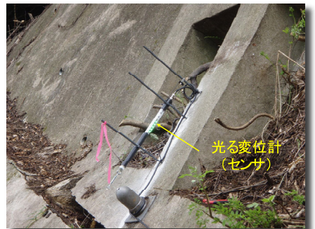
光る変位計の設置状況
