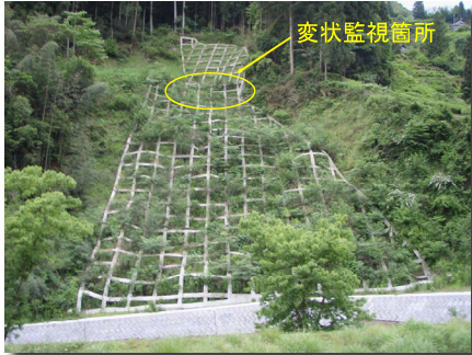
法枠の変状発生現場状況
