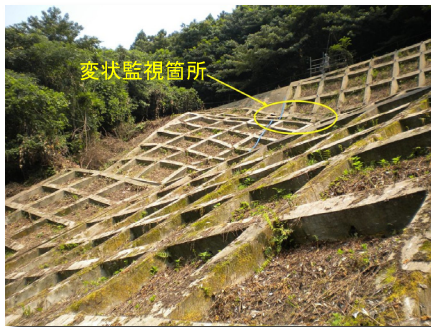
法枠の変状発生現場状況
