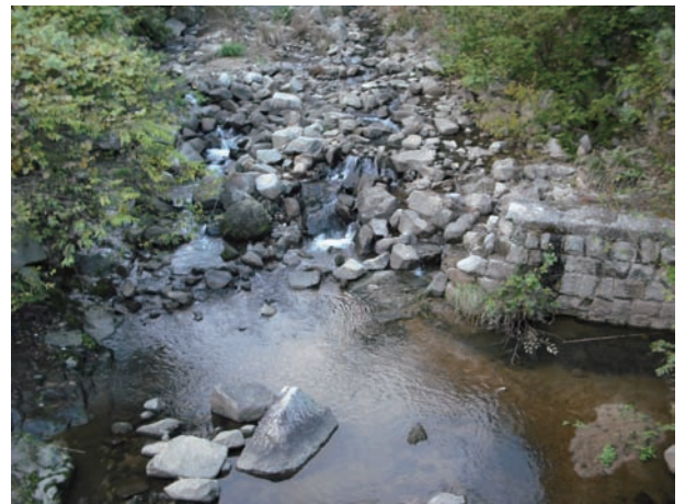
石積み砂防堰堤が破損している事例も見受けられます
