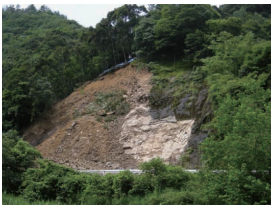
崩壊現場全景
