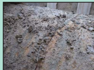
PC管の劣化状況 PC管外周部のカバーコートモルタルが侵食され、PC鋼線がむき出しになっている。
